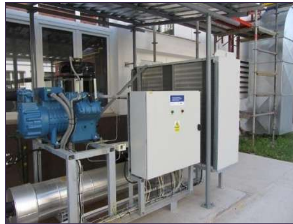
冷却プラント
