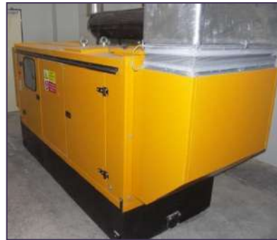
緊急時発電装置
